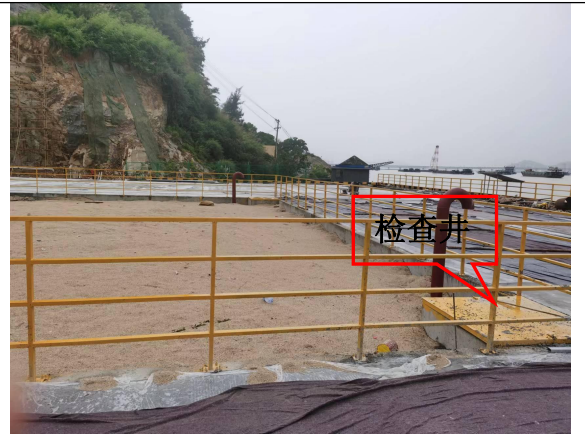
1、2#泊位雨污水沉淀池 (1000m 3 )
