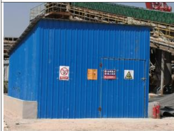
危废临时贮存所
