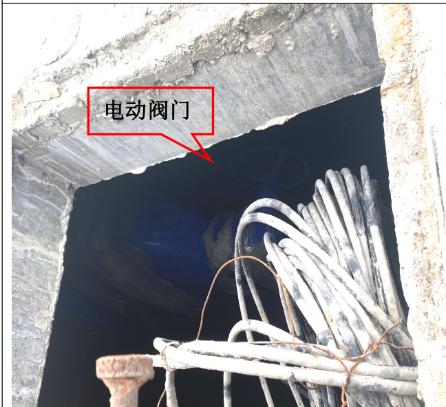
2#初期雨水沉淀池电动阀门
