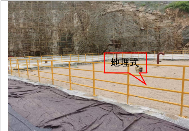
1、2#泊位雨污水沉淀池 (1000m 3 )
